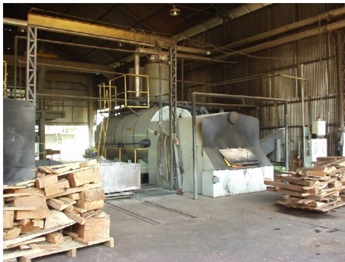
Figura 4 – Usina termoleléricas – (caldeiras)
