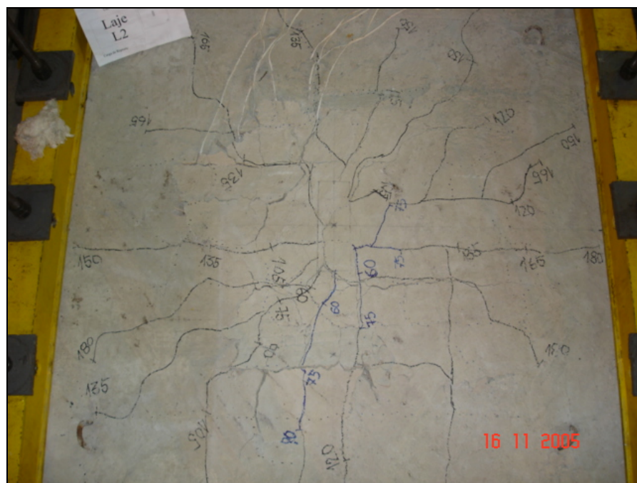
Figura 4.41 – Mapa de fissuração da laje L2
