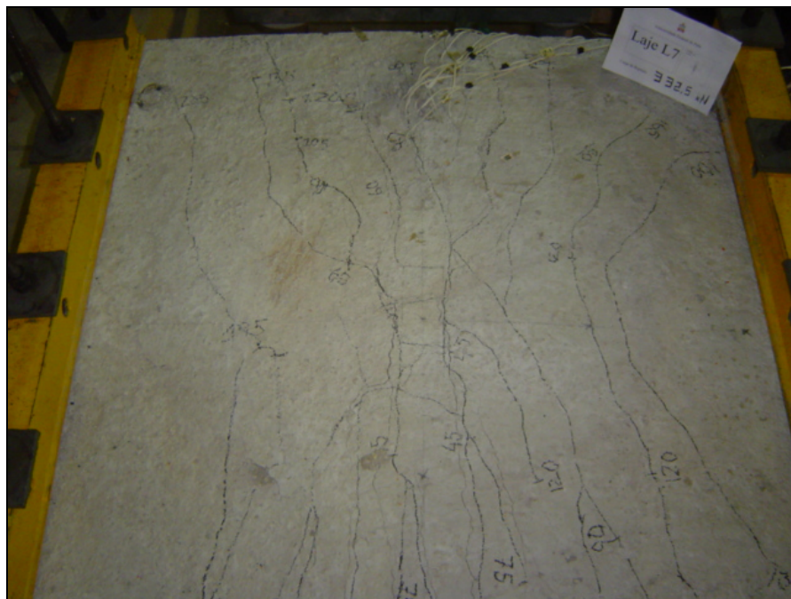
Figura 4.46 – Mapa de fissuração da laje L7
