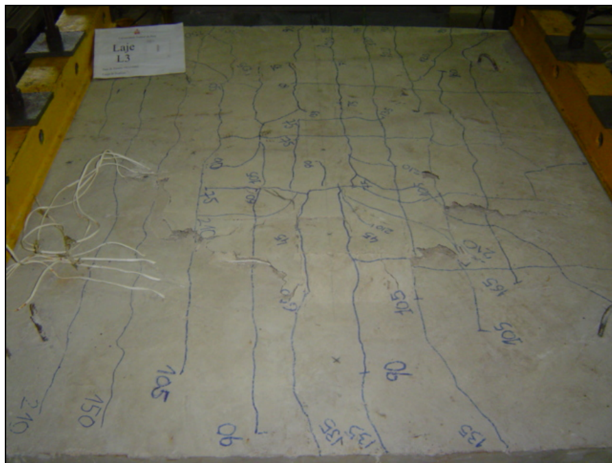
Figura 4.42 – Mapa de fissuração da laje L3
