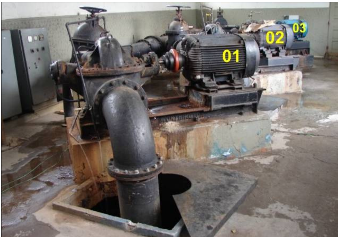
Fotografia 10 - Estação elevatória do 3º setor de abastecimento
