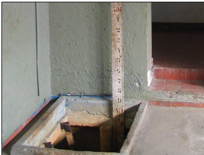
Fotografia 9 – Régua graduada utilizada para medição do nível do reservatório apoiado
