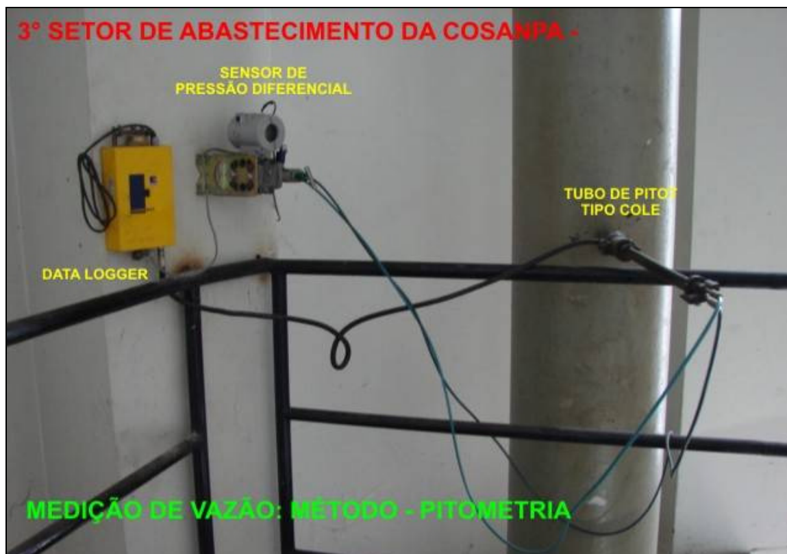
Desenho 26 – Medição de vazão, por pitometria, na saída do reservatório elevado do 3° Setor de abastecimento de água da Região Metropolitana de Belém.
