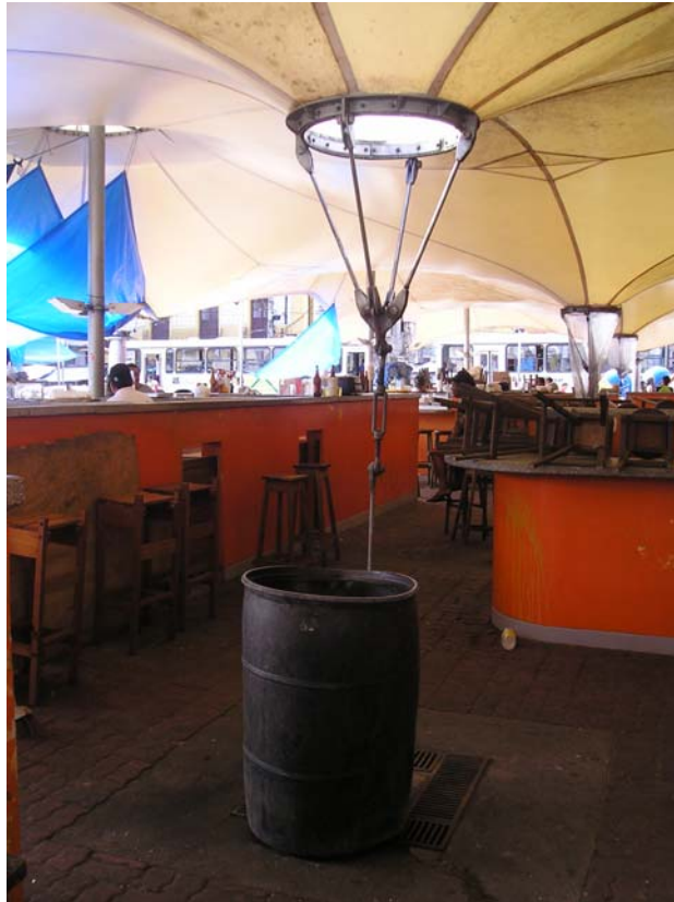
Figura 5.12 - Colocação de um tambor, pelos feirantes, na abertura existente na cobertura para descida da água das chuvas (foto datada de 01/05/ 2005).
