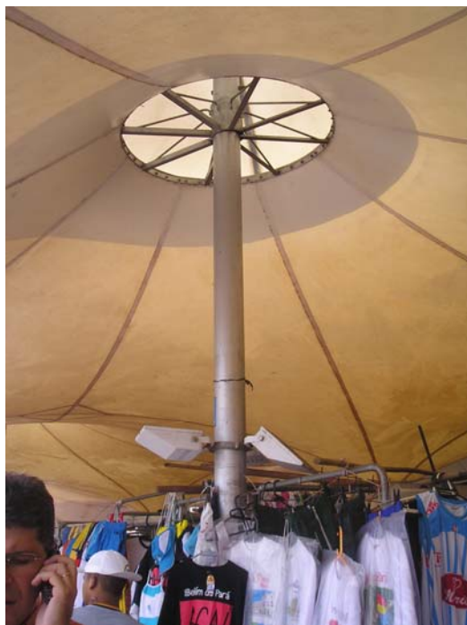
Figura 5.6 – Respiradouro localizado nos pilares centrais (foto datada de 09/11/2005).
