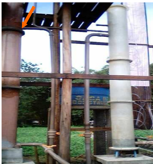
Fotografia 26 - tubulação de entrada do filtro após passar pelo leito de contato.
