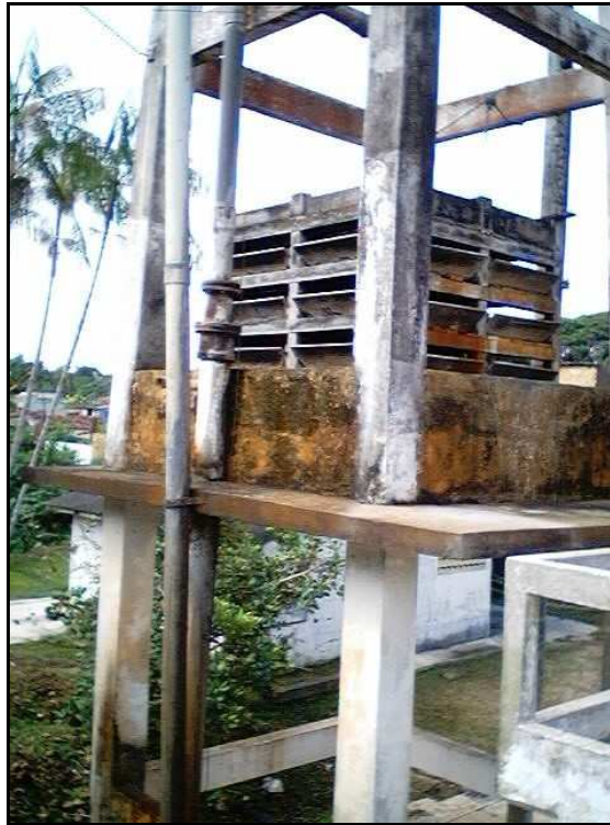
Fotografia 12 - Aerador tipo tabuleiro, localizado no Bairro do Satélite na ETA do IPASEP
