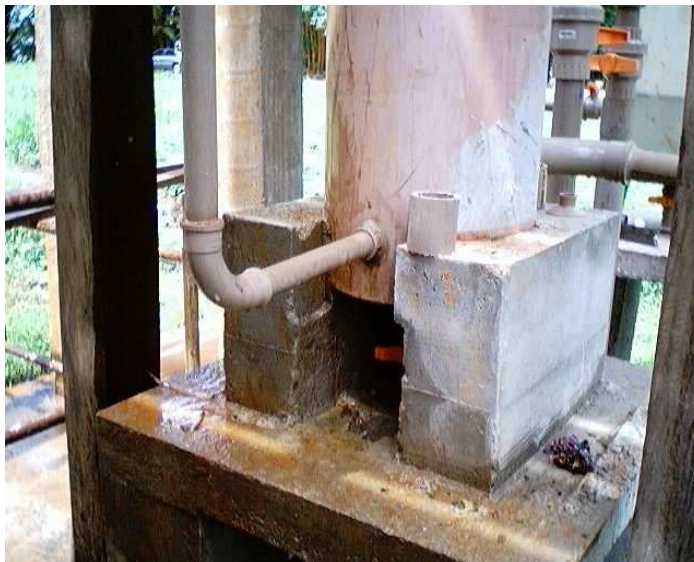
Fotografia 25 - descarga do leito de contato da ETA-Piloto Fonte: Direta
