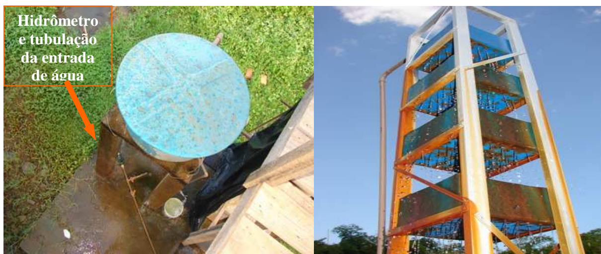
Fotografia 23 - Tubulações de AB que abastece o aerador da ETA-Piloto Fonte: Direta.
