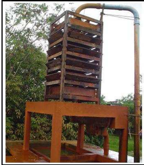
Fotografia 4 - Aerador de Tabuleiros Fonte: Direta (2006)
