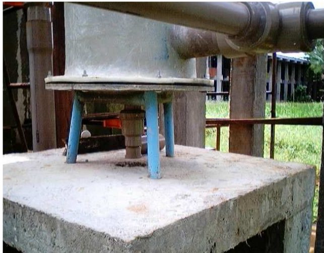
Fotografia 28- Descarga do filtro rápido descendente da ETA-Piloto Fonte: Direta
