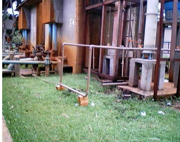
Fotografia 30 - Tubulações da retrolavagem da ETA-Piloto. Fonte: Direta
