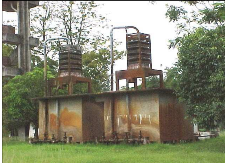
Fotografia 9 - ETA - Tipo Desferrização, localizado na UFPA Fonte: Direta
