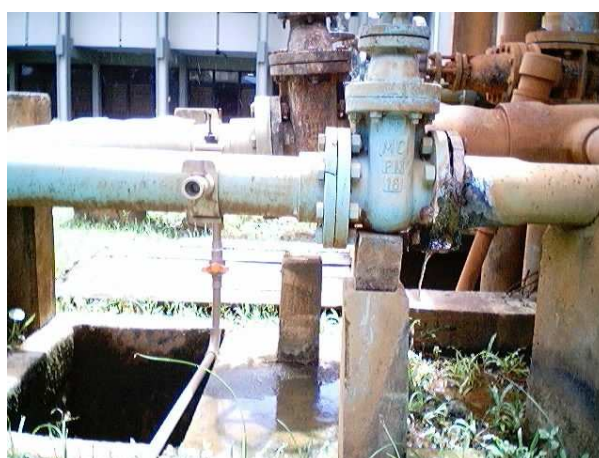
Fotografia 29 – Entrada de água da tubulação da retrolavagem da ETA-Piloto. Fonte: Direta.
