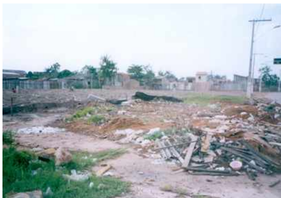
Figura 20 - Sobra de material da habitação demolida no Riacho Doce. Foto da autora. Março/2005
