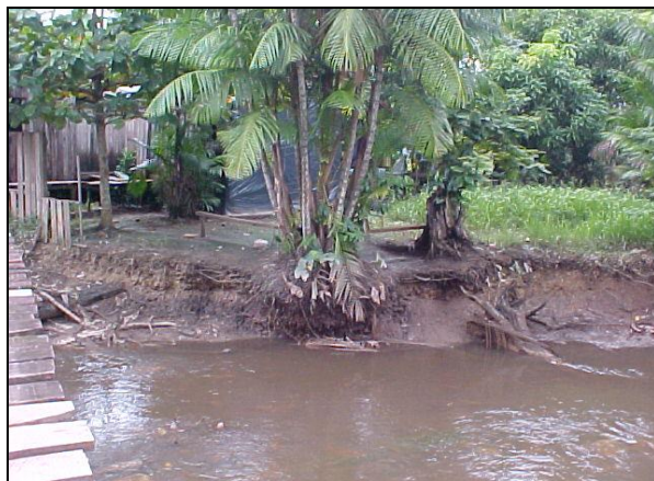
Fotografia 45 – Erosão das margens do igarapé Mata Fome. Fonte: Direta (2006)
