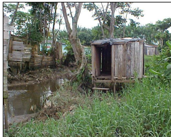
Fotografia 34 – Banheiro lançando esgoto sanitário às margens do igarapé Mata Fome. Fonte: Direta (2006)
