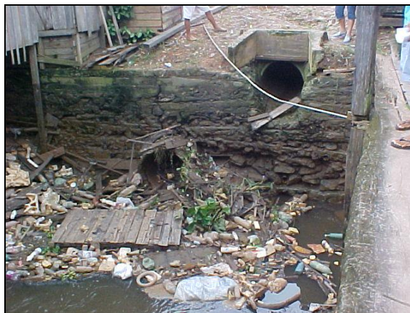
Fotografia 37 – Tubulação de drenagem a montante da Rodovia Arthur Bernardes. Fonte: Direta (2006)
