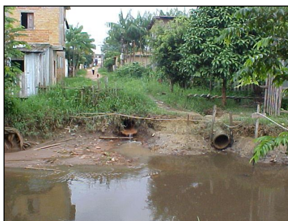
Fotografia 40 – Tubulações de drenagem com lançamento no igarapé Mata Fome. Fonte: Direta (2006)
