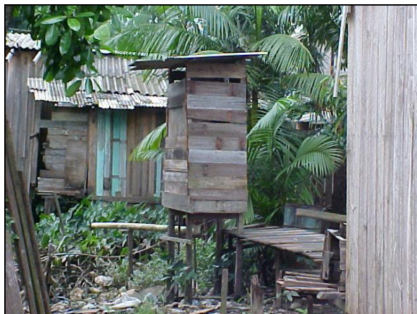
Fotografia 33 – Banheiro lançando esgoto sanitário no solo. Fonte: Direta (2006)
