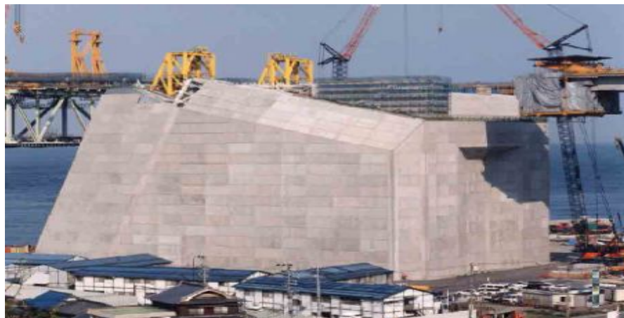
Figura 2.1 - Bloco de ancoragem da ponte Akashi Kaikyo no Japão (1988). Fonte: Okamura e Ouchi (2003).
