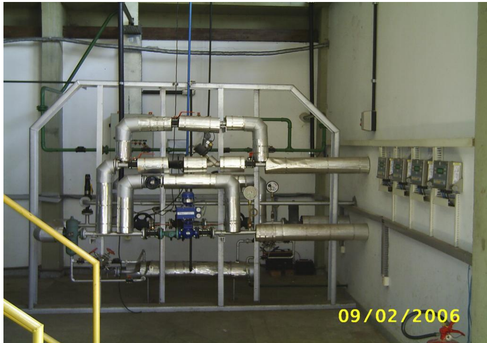
Fotografia 4: Linha de distribuição da energia transformada.
