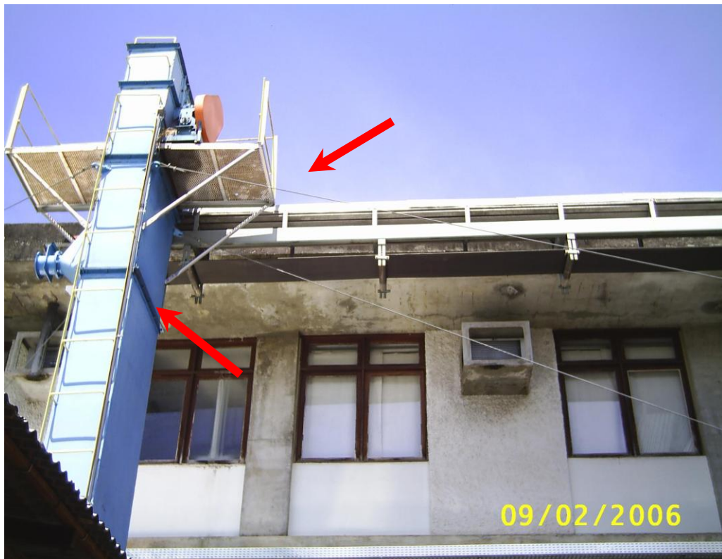
Fotografia 1: Elevador caneca com esteira transportadora para os Silos.
