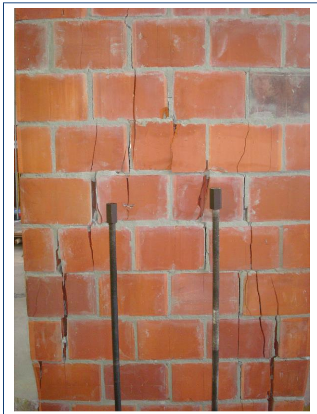
Figura 4.21 – Modo de ruptura das paredes, face frontal posterior
