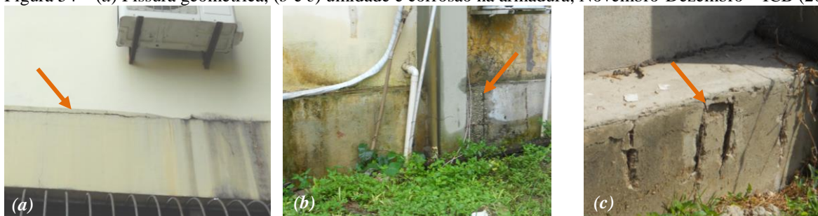
Figura 54 – (a) Fissura geométrica, (b e c) umidade e corrosão na armadura, Novembro-Dezembro – ICB (2013)
