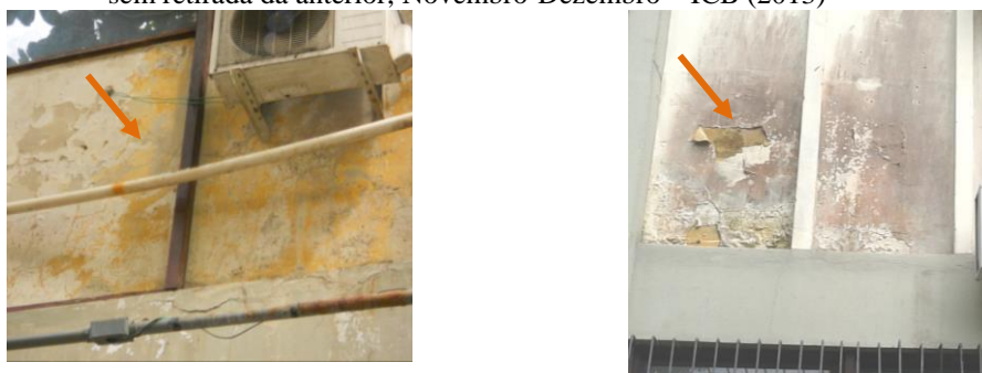
Figura 48 - Pintura encontra-se parcial ou totalmente fissurada com aparência mapeada, havendo destruição do filme e descolamento da argamassa. Observa-se execução de nova camada de pintura sem retirada da anterior, Novembro-Dezembro – ICB (2013)
