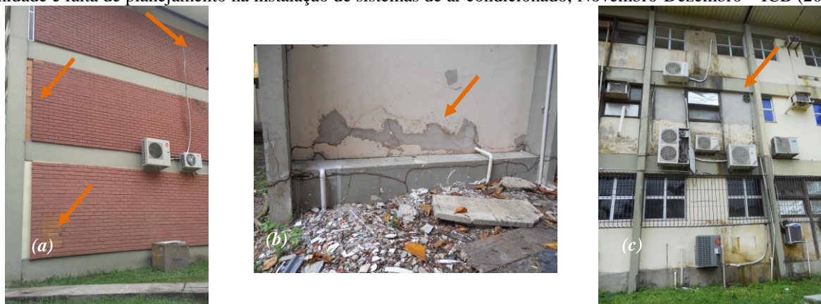
Figura 64 - (a) Reposição de material diferente do original; (b) perfuração da estrutura para canalizações, além da ausência de acabamento final e presença de macro-organismos; (c) fechamento de vãos sem acabamento final, umidade e falta de planejamento na instalação de sistemas de ar condicionado, Novembro-Dezembro – ICB (2013)
