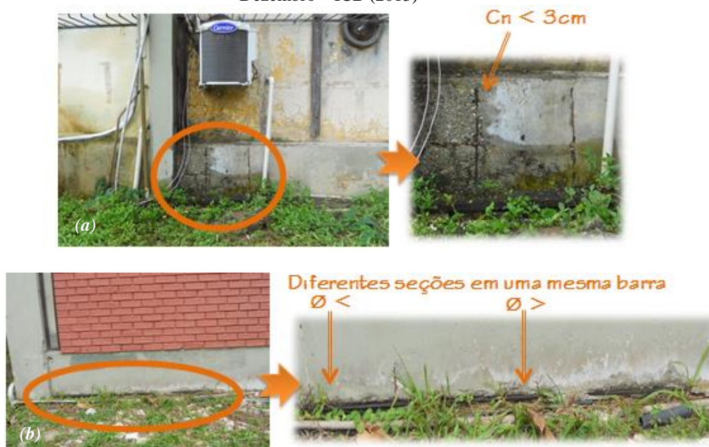
Figura 43 – (a) Insuficiência de cobrimento mínimo e (b) perda de diâmetro da armadura, Novembro-Dezembro – ICB (2013)
