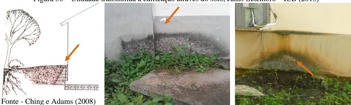
Figura 50 – Umidade transmitida à edificação através do solo, Julho-Setembro – ICB (2013)
