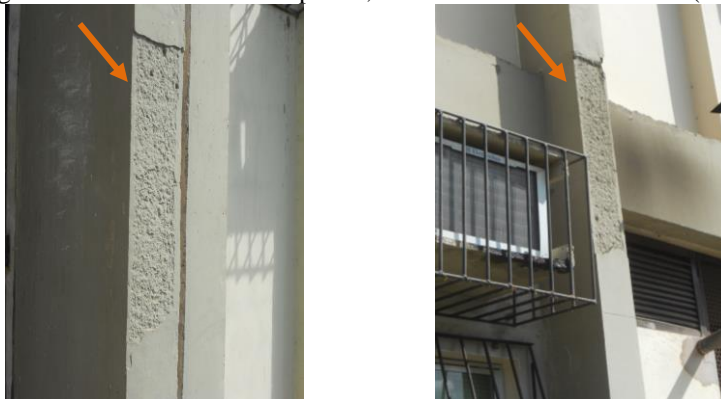
Figura 49 - Descolamento em placas, Novembro-Dezembro – ICB (2013)
