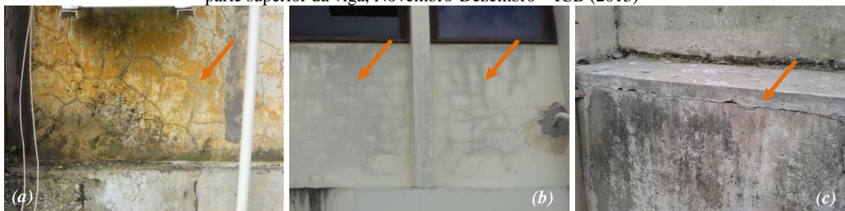
Figura 45 – (a e b) Fissura mapeada, somada ao descolamento e umidade (c) fissura geométrica contornando parte superior da viga, Novembro-Dezembro – ICB (2013)
