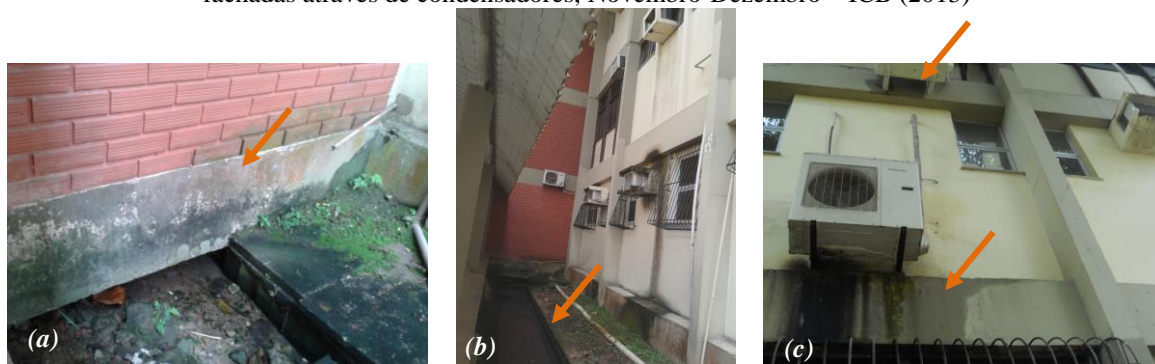
Figura 51 – (a e b) Umidade em galerias de captação de água pluvial e (c) esgotamento de água nas fachadas através de condensadores, Novembro-Dezembro – ICB (2013)
