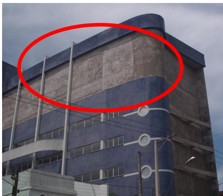
Figura 1.1- Descolamento de revestimento cerâmico na fachada (Madeiro, 2012).
