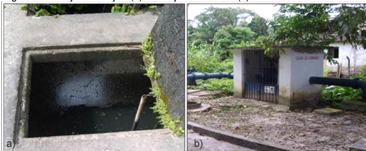
Figura 24 – Poço de sucção (a) e estação elevatória (b) da Unidade EEE – B2.
