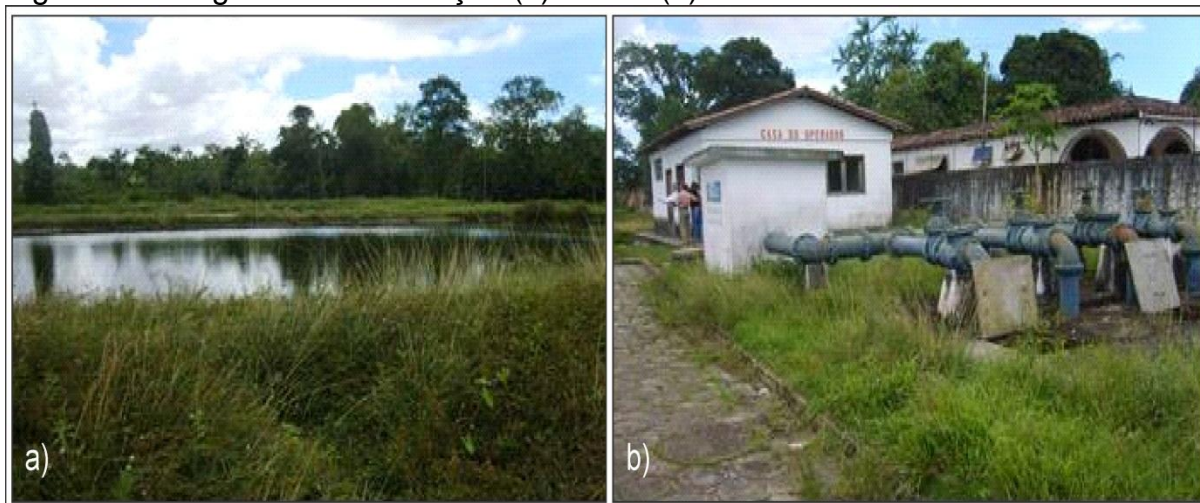
Figura 22 – Lagoa de estabilização (a) e EEE (b) na unidade EEEB-B1.
