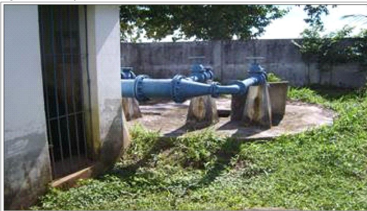
Figura 26 – Estação elevatória do SES EEE-B5.
