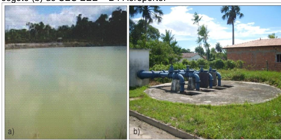
Figura 25 - Lagoa de estabilização (a) e estação elevatória de esgoto (b) do SES EEE – B4 Aeroporto.
