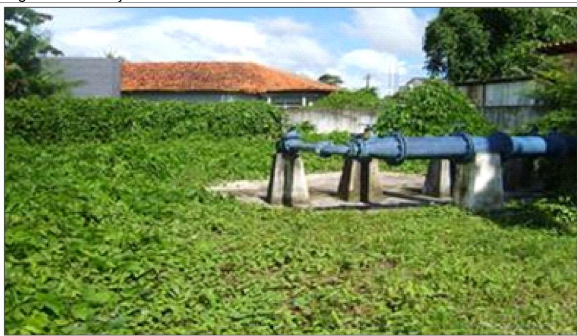
Figura 27 - Estação elevatória SES EEE – B6.
