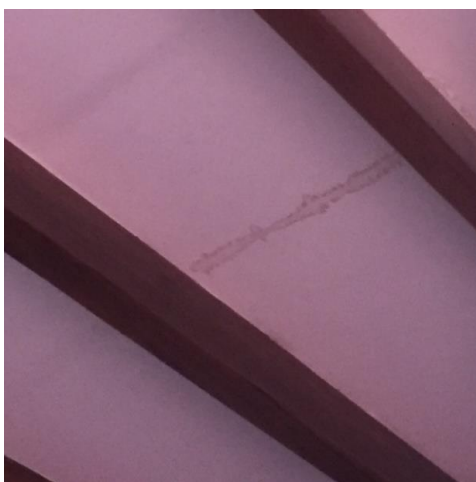
Figura 68 - Fissura Inferior entre V4 e V5
