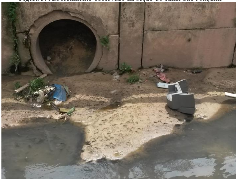
Figura 3: Assoreamento observado na seção do canal São Joaquim
