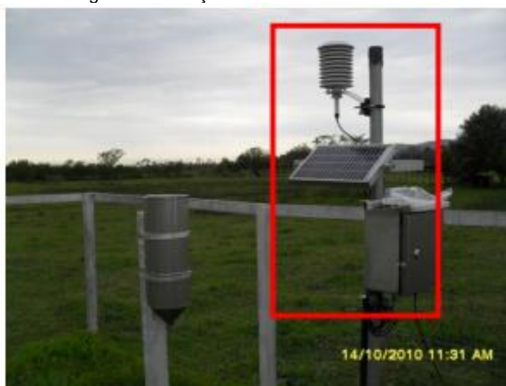
Figura 9 – Estação fluviométrica automática.
