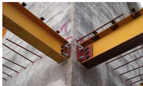
b) Ligação entre viga metálica e pilar ou parede de concreto, tirado de www.omrannosazi.com , em 20/10/2015.
