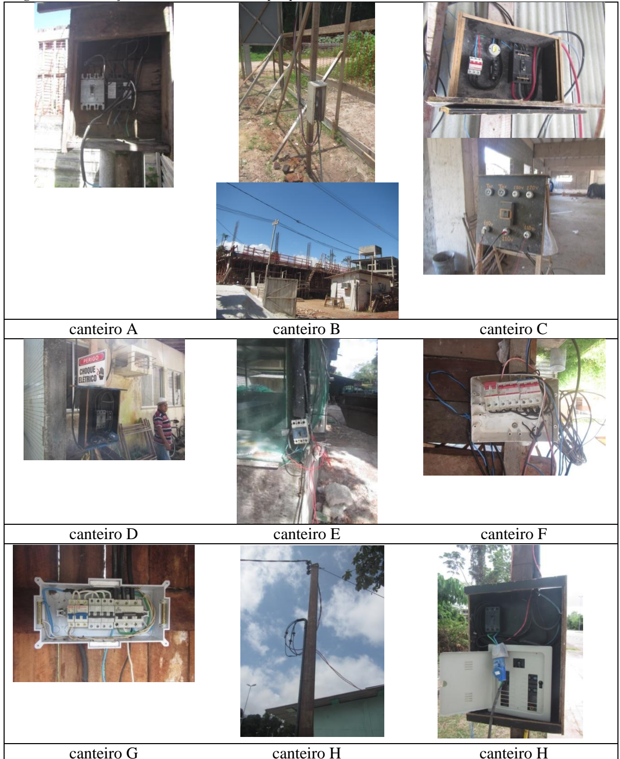
Figura 18 - Instalações elétricas dos canteiros pesquisados
