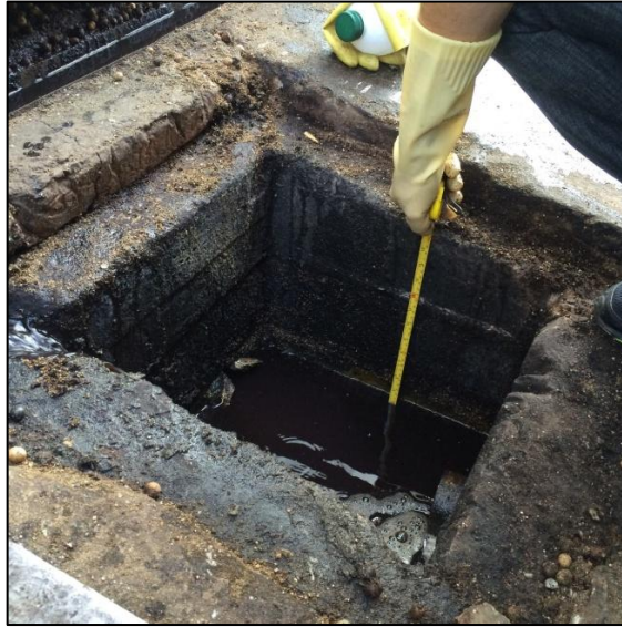
Figura 7- Caixa receptora de água residuária
