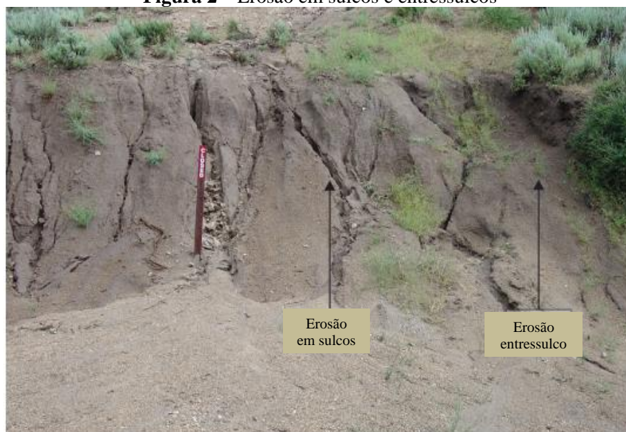
Figura 2 – Erosão em sulcos e entressulcos
