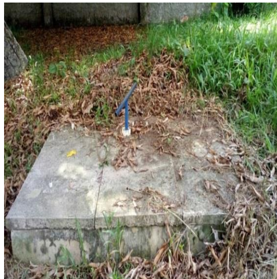
Figura 37. Registro na entrada do R.A.
