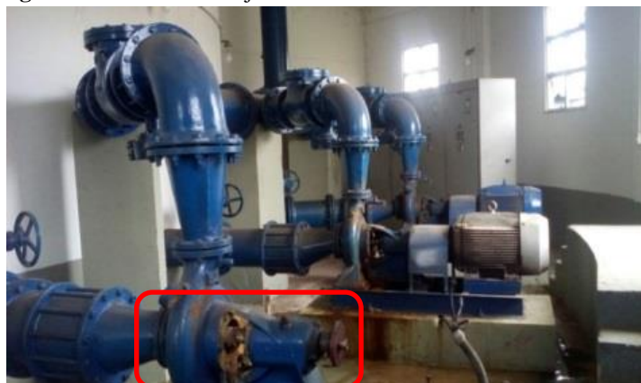
Figura 33. Visão dos conjuntos motor e bomba e do CCM ao fundo.
