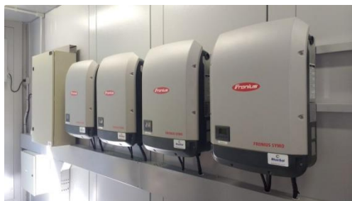
Figura 42- Inversores conectados à rede (Inversor Grid-Tied).
