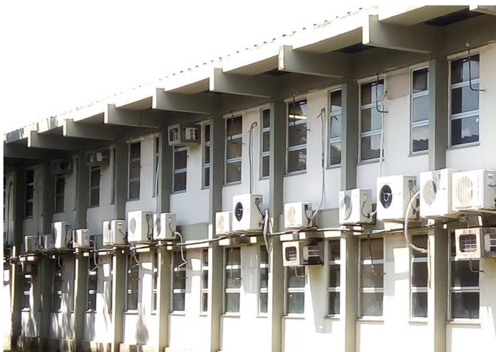
Figura 4.1 - Diferentes equipamentos de refrigeração
