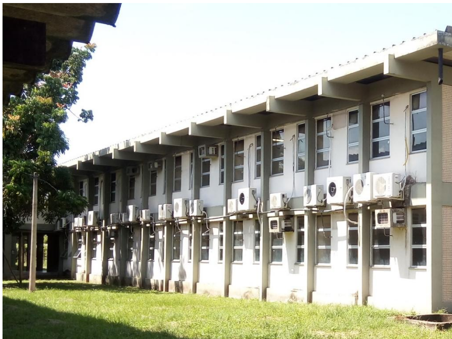
Figura 4.19 - Vista externa do prédio e dos aparelhos de refrigeração.
